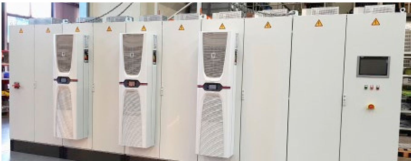
Nur ein Teil des großen Ganzen: Die Reinigungsanlage weist insgesamt große Dimensionen auf, in denen ein hohes Maß an technischer Raffinesse steckt.
